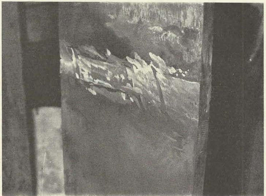
4. ábra. A kijavított, átszakadt repedés
