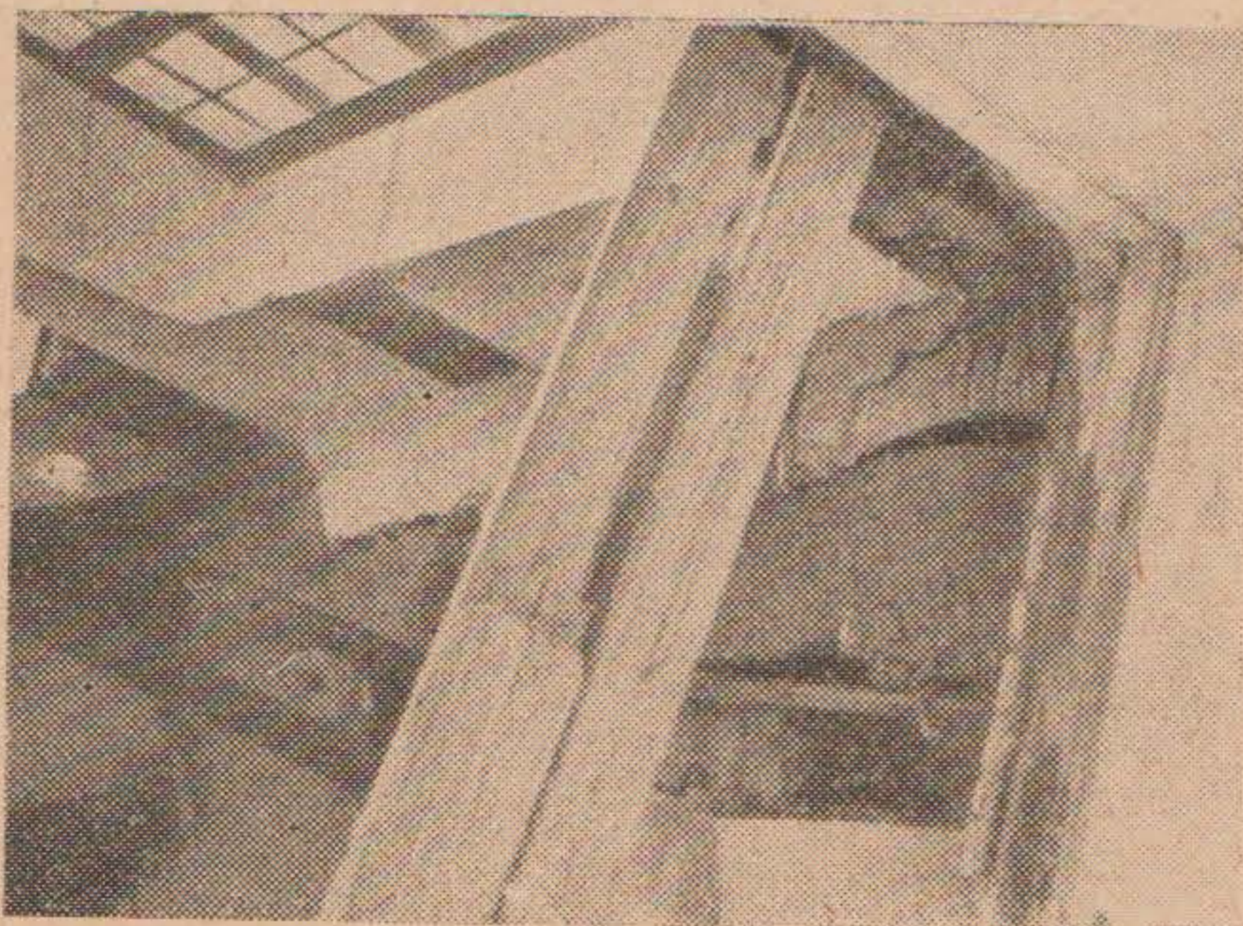
2. kép. Gombásodás hatására leszakadt földémszerkezet.
