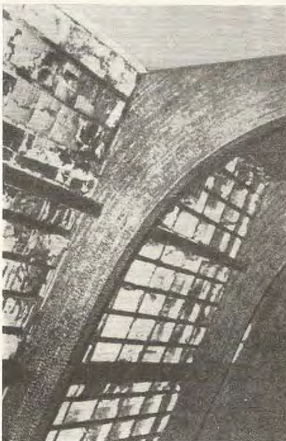
6. ábra. Rétegelt tartókkal készített tetőszerkezet tűz után
