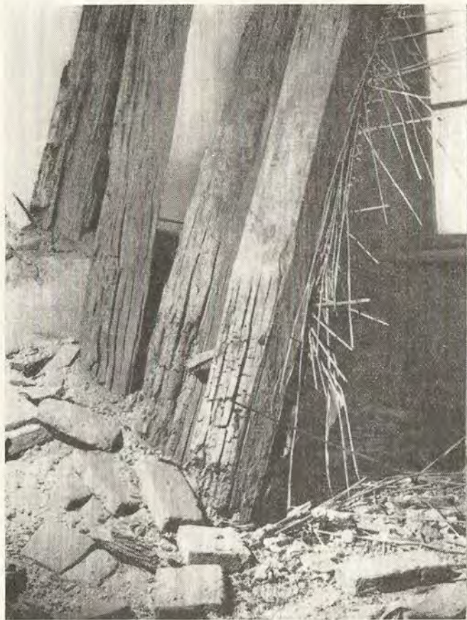
1. ábra. Gombafertőzés következtében leszakadt födémgerendák
