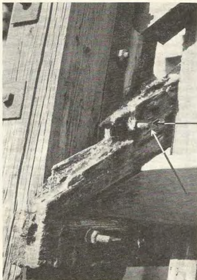
15. ábra. Hűtőtornyok elkorhadt faszerkezete
