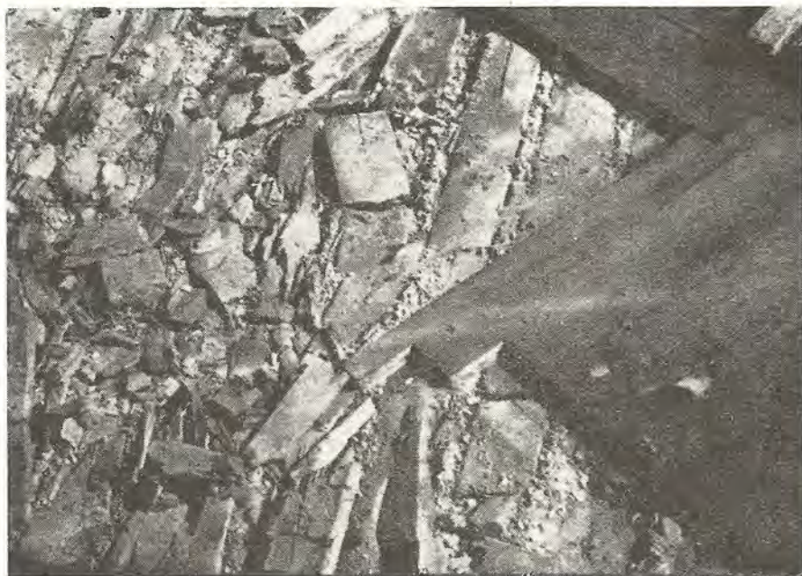
3. ábra. Terminális állapotú padlóburkolat
