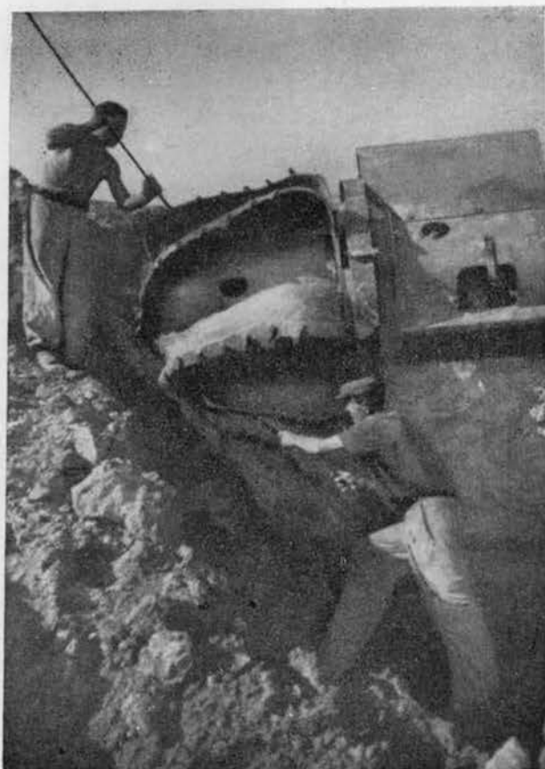
32. ábra. Rudabányán a lágy fedőréteget jorgófejes kotró termeli le. Az elkülönített szállítás jól biztosítható az állítható szalagrendszerrel
